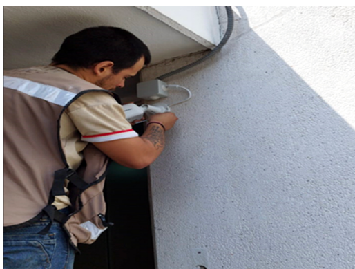
Proyecto de Modernización de los Sistemas Análogos de Videovigilancia de las Salas Regionales Ciudad de México y Monterrey. Dirección General de Protección Institucional.
