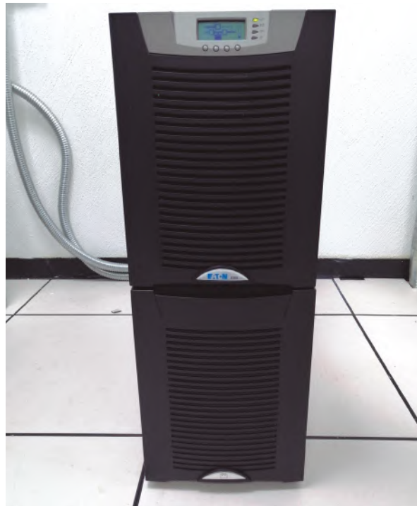
Equipos de respaldo de energía (UPS).
